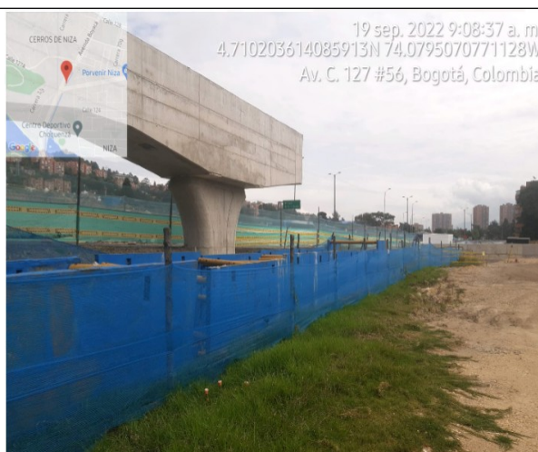
Fotografía No 6. Construcción Box Culver, Sección Oriental, Calle 127 y 127 A con Av Boyacá, en estado suspendido, Canal Niza.
